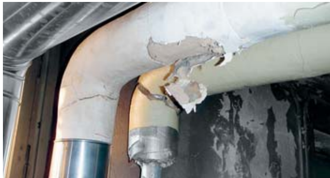
Rohrleitung mit asbesthaltigem Mörtel
