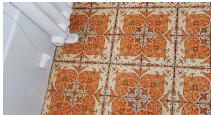
Typisches Muster eines mehrschichtigen asbesthaltigen Bodenbelags
