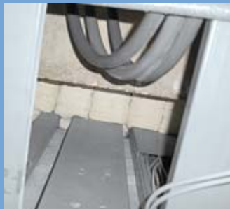
Brandabschottung mit Asbestkissen
