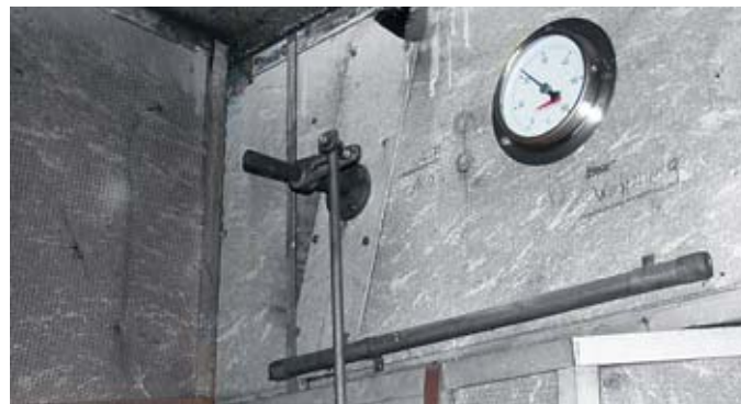
Lüftungskanal aus Asbestzementplatten
