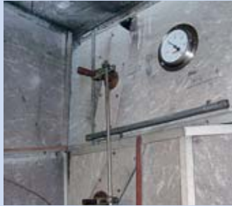
Lüftungsanlage aus Asbestzement
