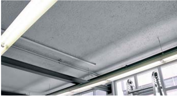
Spritzasbestbelag an Decke
