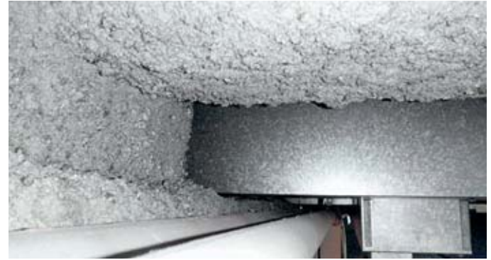
Spritzasbest als Brandschutz an Metallträger
