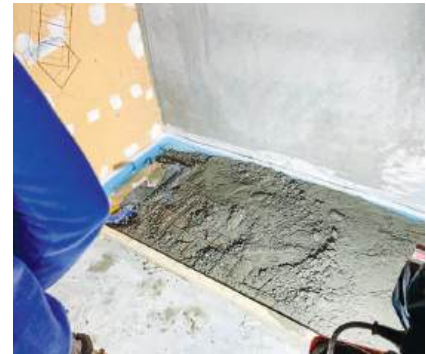
Anstelle von Badewannen werden nun Duschen eingebaut, hier wird der Gefällsüberzug erstellt
