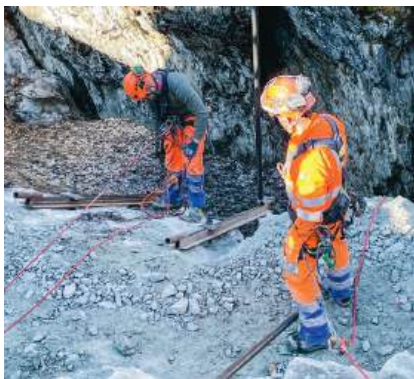
Die Firma Ghelma erstellte für uns das Arbeitsgerüst, 20m über der Ova da Bernina
