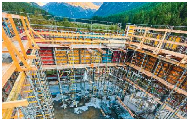
Das zukünftige Holzlager. Bei so einer Schalhöhe kamen Staxo Elemente zum Einsatz
