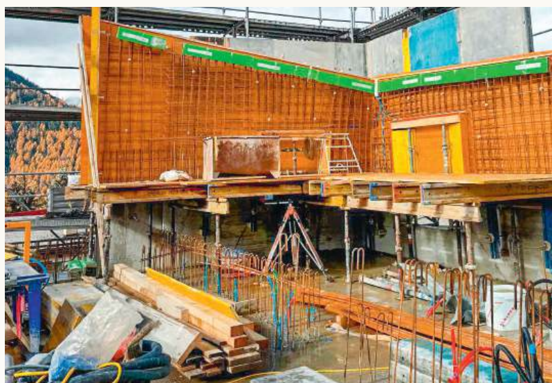
Giebelwand: gut ersichtlich die erste Betonieretappe bis zum Gerüstboden (wo der Knick ist) und die nächste Etappe bereit zum Zuschalen
