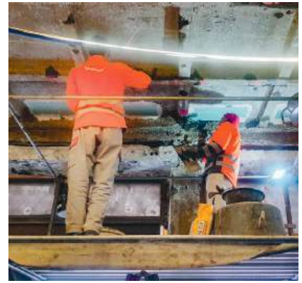
Teils sichtbarer Armierungsstahl der Decke musste saniert werden
