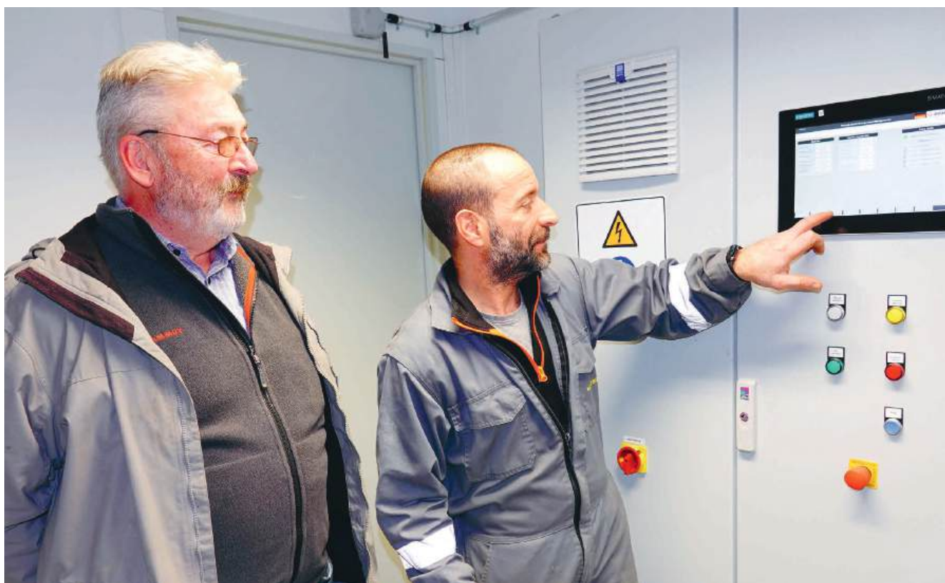
Betriebsleiter Flurin Wieser und Disponent Fernando da Silva Pereira erklären im Technikraum die Anlage
