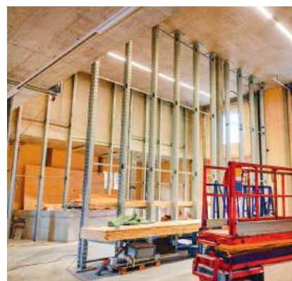
Im Holzlager stehen 7.6m hohe Hochregale
