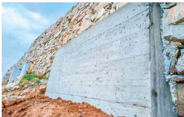
Die vorbetonierten Mauern sind im Fels verankert und werden später noch farblich angepasst
