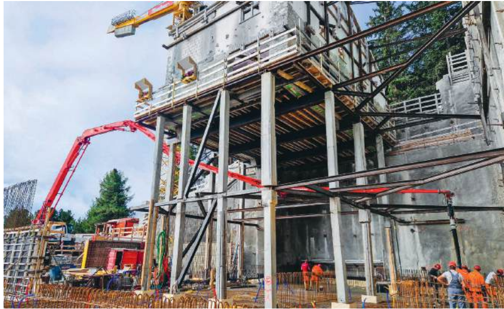
Alles andere als einfach, den Deckenbeton an den richtigen Ort zu bringen
