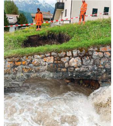
Schäden wie diese verlangten unkomplizierte Sofortmassnahmen
