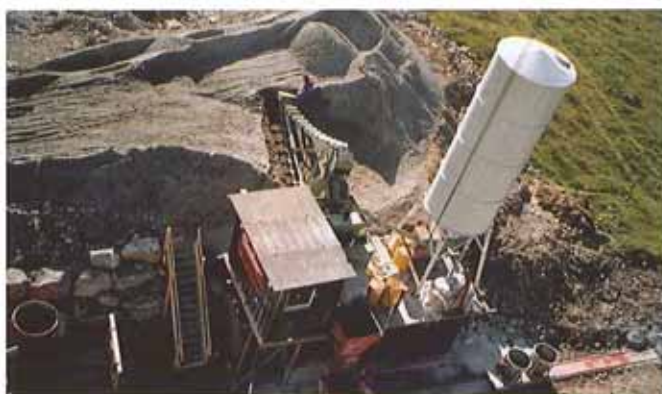
Betonanlage/ Impianto per calcestruzzo
