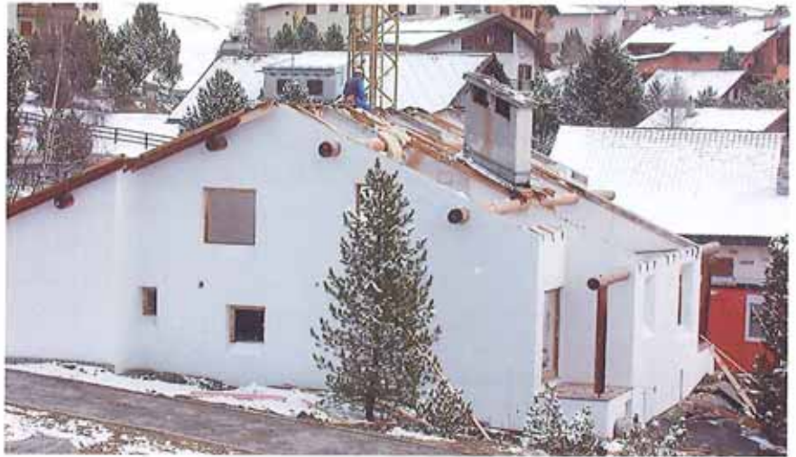
Dachabbruch, ganze Sparren waren durchgefällt
