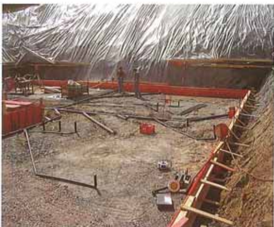
Abschalung Haus D / Armatura casa D
