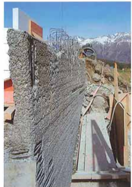
Gut ersichtlich die einzelnen Armierungseisen, die freigelegt wurden. Die Armierung wies zum Teil erheblichen Lochfrass auf. Einzelne Stäbe waren komplett durchgerostet
