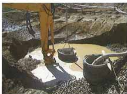
Pumpensumpf / Pozzo di drenaggio
