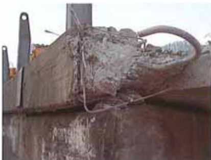
Zum Teil total «verfallener» Beton, der mit dem Abbauhämmer locker abgetragen werden konnte
