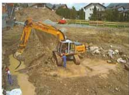
Sickergrube, Verbindung zu Pumpensumpf / scavo per drenaggio allacciati ai pozzi
