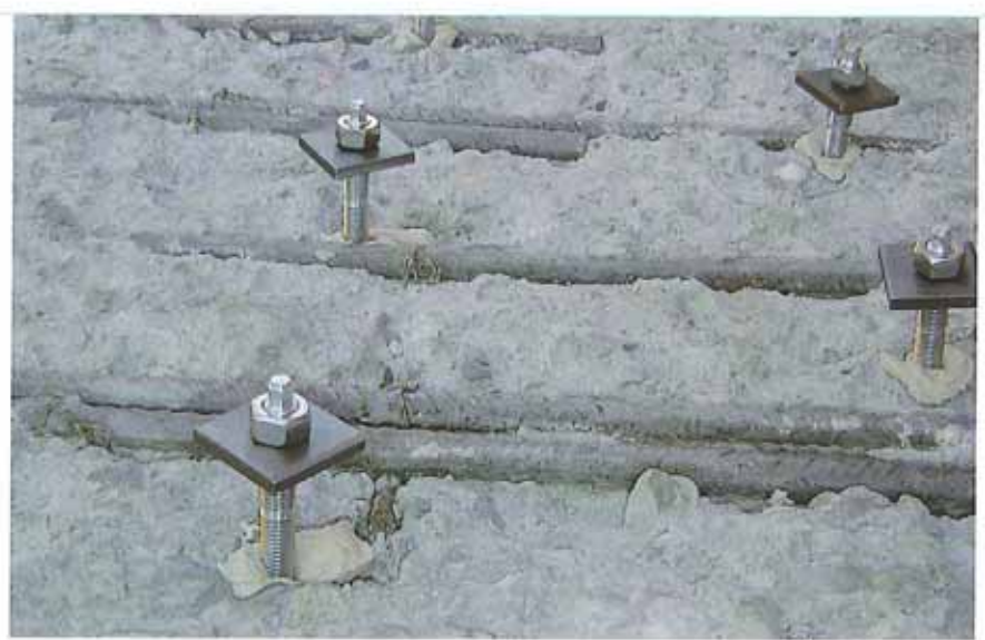
Als zusätzlicher Verbund mit dem Überbeton wurden 1800 Verbundanker in die alte Fahrbahn versetzt
