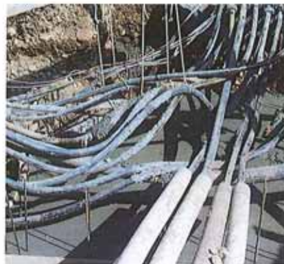
Kabelblock vor Trafostation Blocco di cavi davanti al trasformatore
