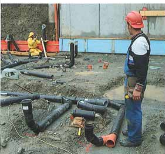
Kanalisation unter der Bodenplatte Canalizzazione sotto platea
