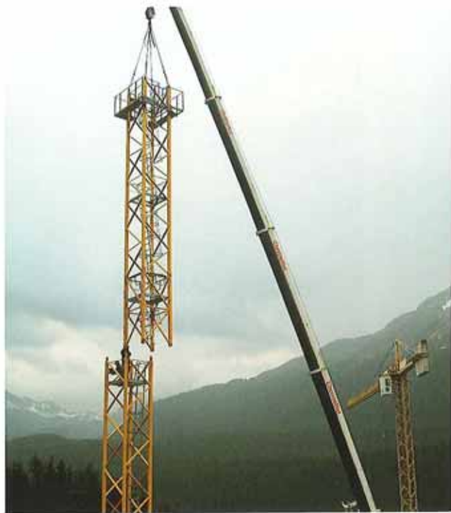
Montage des neuen Krans MDT 120 auf der Baustelle Ovel dal Mulin in St. Moritz
