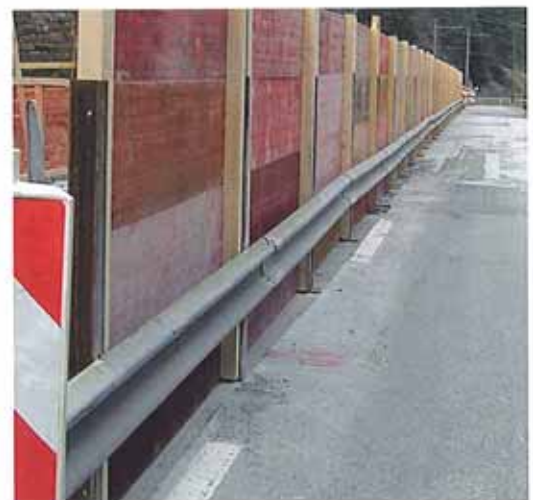
Mittelabschränkung mit aufgeschweisster Leitplatte
