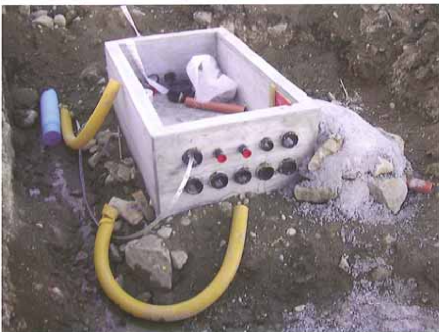
Grosser Kabelzug-Schacht bei der Alp Languard
