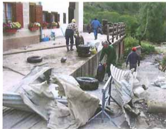
Das Engadiner Haus, in dem wir die Keller räumten. Zuerst galt es sämtliches Material ins Freie zu bringen
