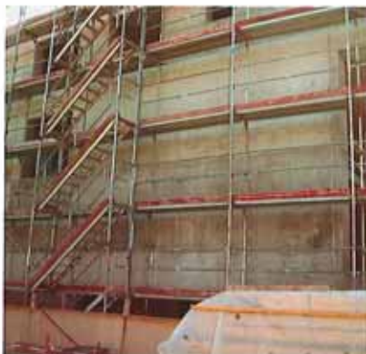
Fertige Nord-Sichtfassade. Hier noch mit Austrocknungsflecken, die jetzt nicht mehr sichtbar sind
