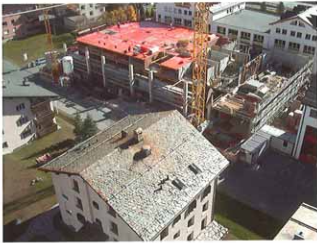
Viel Platz war für die Installation nicht vorhanden
