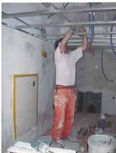
Decke im Korridor und Badezimmer herunterhängen
