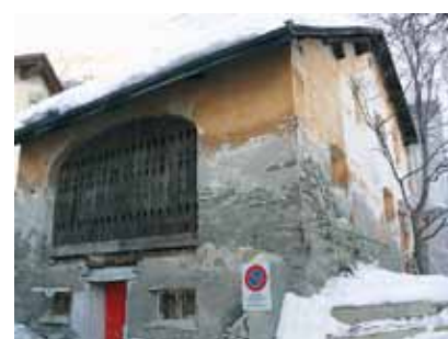
Umbau Stalla, hier gibt es noch einiges zu tun, doch innen sind die Rohbauarbeiten fertig
