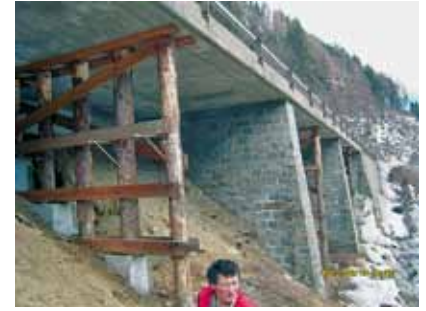
Die alten Brückenplatten waren aus Sicherheitsgründen bereits vor ca. 10 Jahren abgestützt worden
