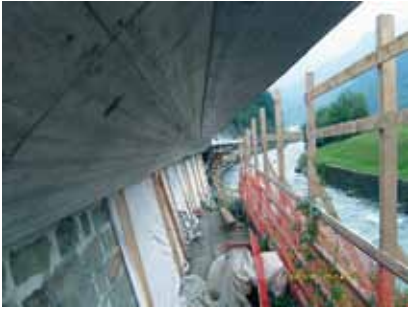
Kordonuntersicht, auch hier muss alles auf den cm stimmen, damit das Auge eine schöne Linie erkennt. Des Weiteren musste die bestehende Bruchsteinwand saniert werden.
