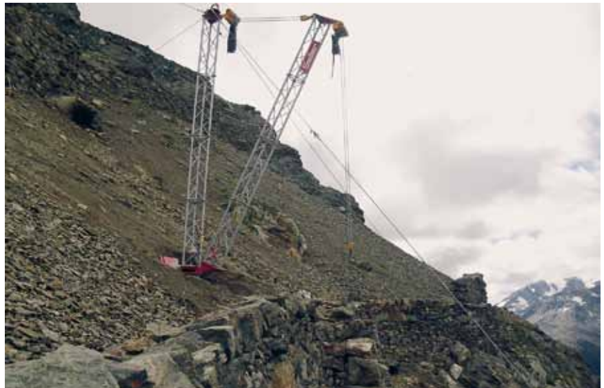
Unser selbsterfundener Baustellenkran, (eine Eigenkonstruktion) mit einer Ausladung von 8 Metern und einer Hublast von 3 Tonnen
