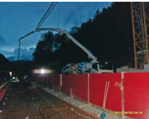
Betonieren mitten in der Nacht, das Foto entstand um 04.16 Uhr. Je nach Wetter, Wind, Wärme, Kubatur und Verkehr war es besser sehr früh am morgen mit der Betonage zu beginnen.
