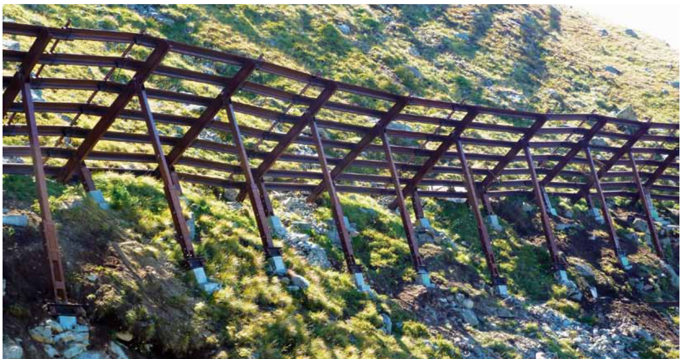
Stahl-Lawinerverbauung mit den, z.T. neu erstellten Fundationen
