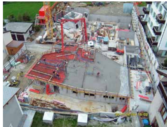
Betonieren der Decke über EG. Im Hintergrund nimmt das MFH Seglias Formen an
