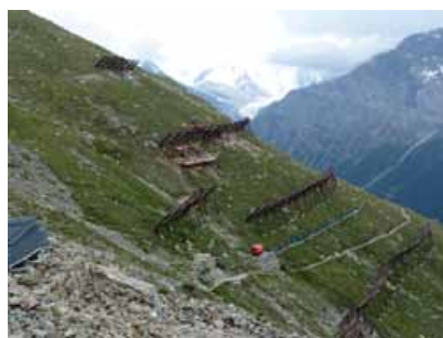
Die Stahl-Lawinenverbauungen an welchen die «Fundamente/Unterfangungen» saniert werden müssen
