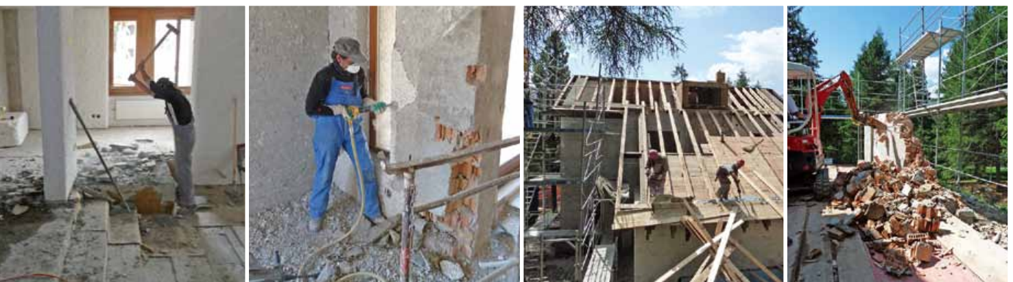
Die Abbrucharbeiten beginnen. Im ganzen Haus wurde der grobe Verputz abgespitzt, das Dach entfernt und die Aussenmauern vom Hallenbad abgebrochen.
