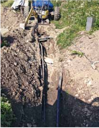
Überall hatte es bestehende Leitungen längs und quer zum Grabenprofil
