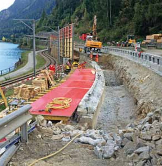
Bis zu 1.30m springt der neue Kordon über die bestehende Stützmauer hinaus
