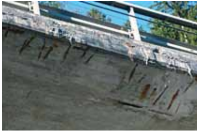
Ein Bild von der Etappe 2013, das aufzeigt wie dringend es eine Sanierung braucht
