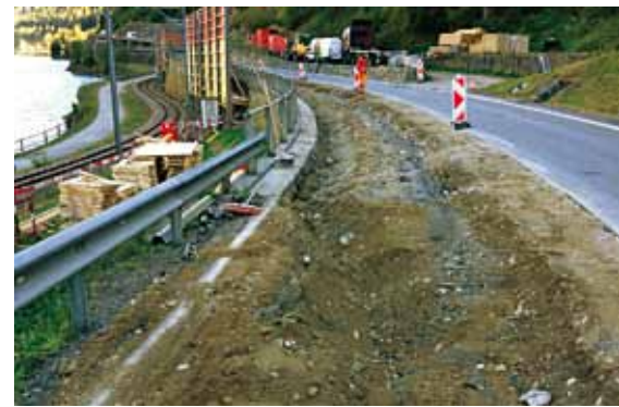
Endlich konnte man bei Tag arbeiten. Die Aushub- und Abbrucharbeiten konnten beginnen.
