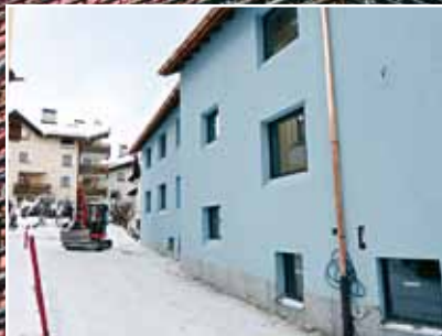
Die Quartierstrasse war kurz vor Weihnachten wieder problemlos befahrbar
