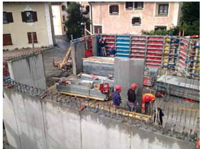
Das Erdgeschoss entsteht. Das Mehrfamilienhaus wird direkt an ein bestehendes Haus gebaut
