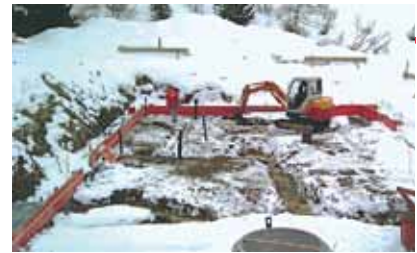
Leitungsvertiefungen, nicht gerade wie man es sich wünscht
