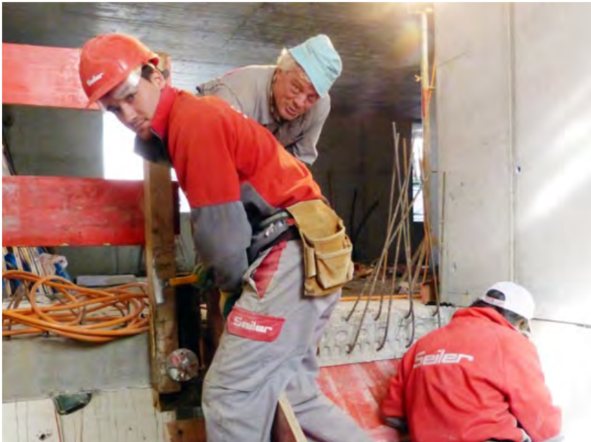
Pelazzini Carlo, Da Silva Nogueira José und Balatti Rocco schalen nachträglich die Betontreppen
