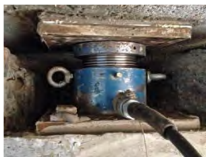
Mit diesen hydraulischen Pressen wurde die bestehende Brücke angehoben, um den Ausbau der Lager zu ermöglichen
