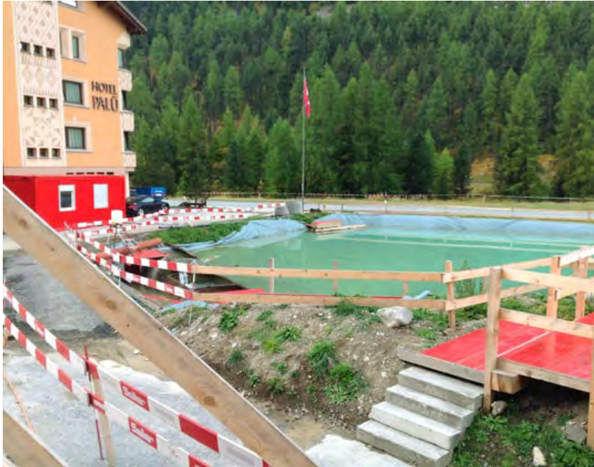
Hotel Palü mit Seeanstoss! Unser Absetzbecken mit Flockungsanlage
