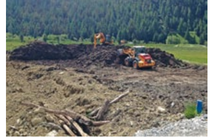
Abtrag Vegetationsschicht mit Transport auf Zwischendeponie, dabei kam viel Altholz zum Vorschein
