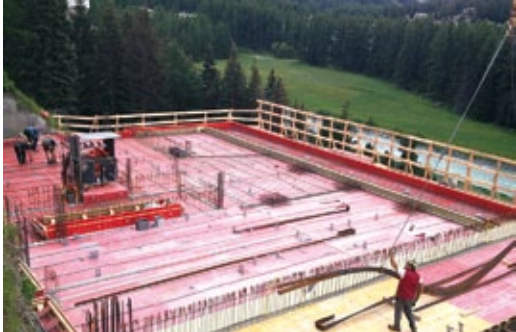
Haus 3B: 2. OG bereit zum Verlegen der Bewehrung. Man beachte die Aussicht!
