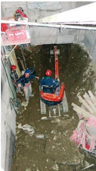
Dies die Unterfangungen des Skiraumes des Sporthotels. Von ganz unten wird später ein Lift direkt ins Hotel führen.
