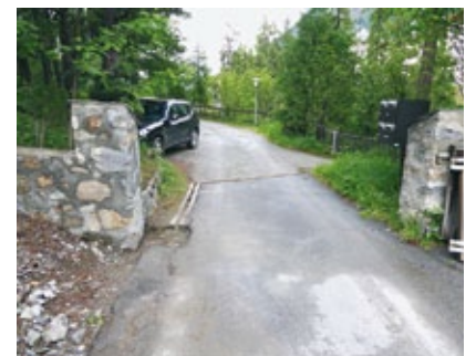
Der linke Bruchsteinpfeiler musste um gut einen halben Meter versetzt werden, um eine LKW Zufahrt zu ermöglichen
