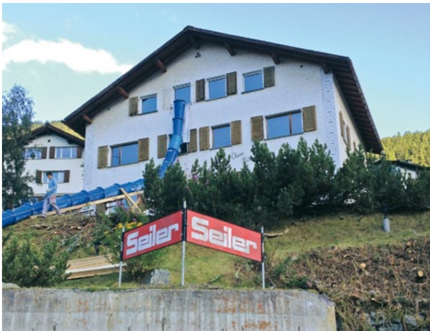
Sicht von Aussen mit Schuttrohrrutsche
