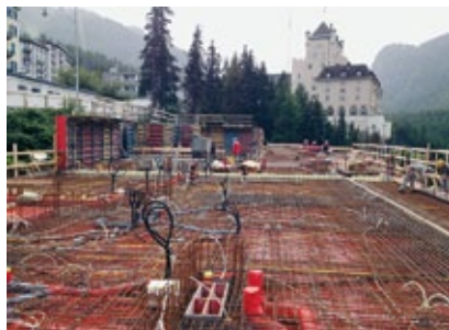
Haus 3A: Decke über 3. OG bereit zum Betonieren. Hinten: Schalungsarbeiten an den Wänden im 4. OG Haus 3B.
