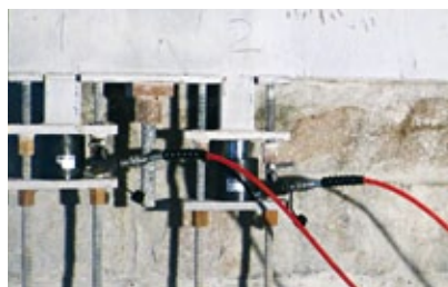
Mit einem ausgeklügelten System bestehend aus acht solcher Pressen wurde die Fahrbahnplatte angehoben
