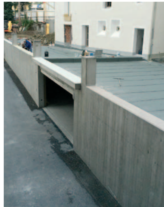
In den Sichtbeton Wänden bei der Einfahrt gibt es keine Betonierfugen zwischen Wand/Decke und Brüstung. Die Sichtstruktur wurde mit stehenden Schalbrettern erstellt.
