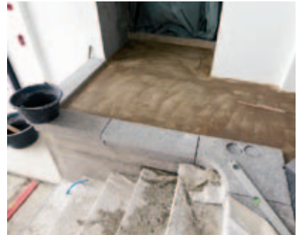
Zum Teil neu angefertigte Abschlüsse neben den Bestehenden, es ist kaum ein Unterschied zu erkennen.
