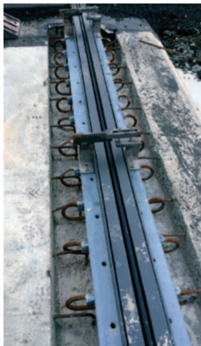
Die alten Fahrbahnübergänge wurden alle entfernt, neu gibt es nur deren 2 Stück, hier kurz vor dem Einbetonieren.
