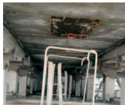
Mit Wasserhochdruck wurden Teile der Pfeilerköpfe oder zum Teil sogar der ganze obere Teil abgetragen.
