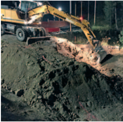
In der Nacht vor der grossen Versetz- übung wurde der Voraushub ausgehoben.
