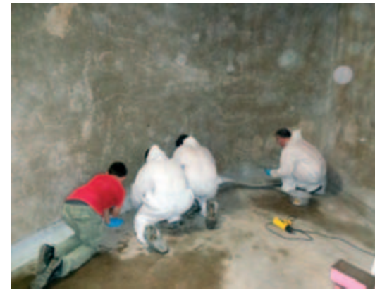
Reservoir Sanierung: als erstes klebten wir die Fugen mit Sika Combiflex ab.
