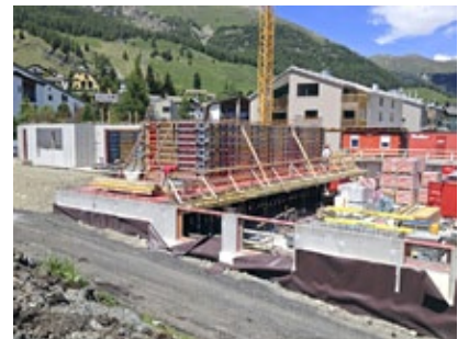
Das Erdgeschoss ragt auf die Garagendecke hinaus, die Garagendecke wurde aber erst nach dem Aufrichten des Daches betoniert. Bis dahin stand alles auf einer provisorischen Abstützung.
