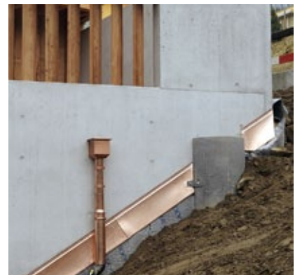
Sichtbeton der keine Wünsche offen lässt.
