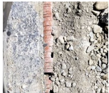
Die Sickerleitung wie sie zum Vorschein kam. Gelochte Rohre wären sicher billiger gewesen als alle paar Zentimeter einen Schlitz zu fräsen.
