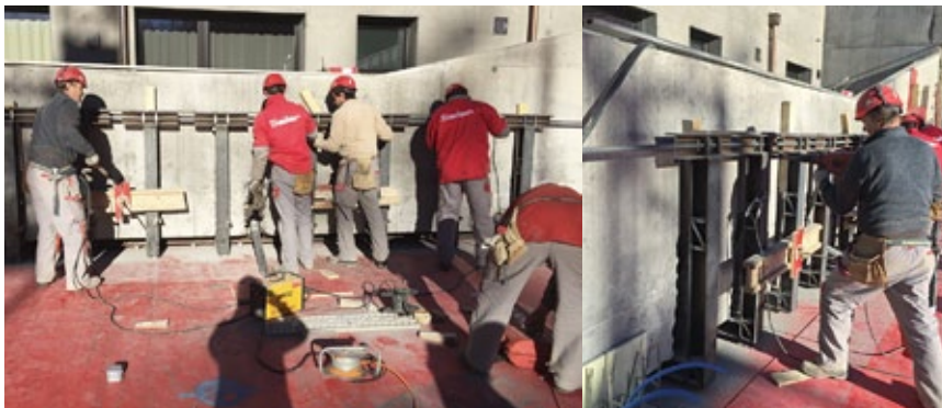
Spezielle Methode mittels Stahlträger zum Abfangen der bestehenden Decke, über die neu zu erstellende Decke.
