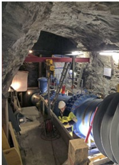
30 m unter Boden ist die angepasste Druckleitung die nach Cavaglia führt.
