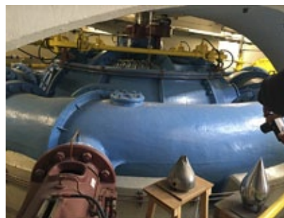
Geschlossene Turbine von oben. Vorne ein abgenutzter und ein neuer Einspritzkopf.
