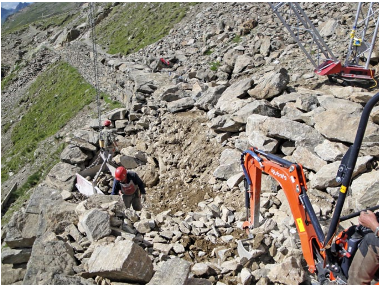
Abtrag der abgerutschten Natursteinmauer mittels Kran und Kleinbagger. Es ist gut ersichtlich, wie die Mauer ins Rutschen geraten ist.
