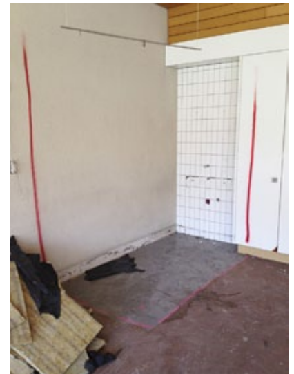
In jedem Schulzimmer befand sich eine Ecke mit asbesthaltigem Fliesenkleber.
