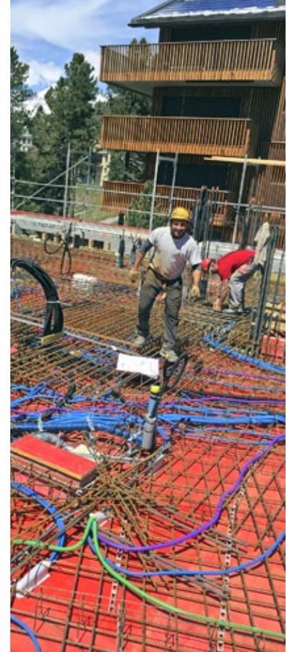
Am 20. Mai 2016 sah es in etwa gleich aus wie vor Weihnachten. Betonieren der Decke über Ebene zwei.
