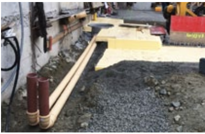
Unter der Bodenplatte wurde isoliert und Leitungen zum Abführen des Radongases eingelegt.
