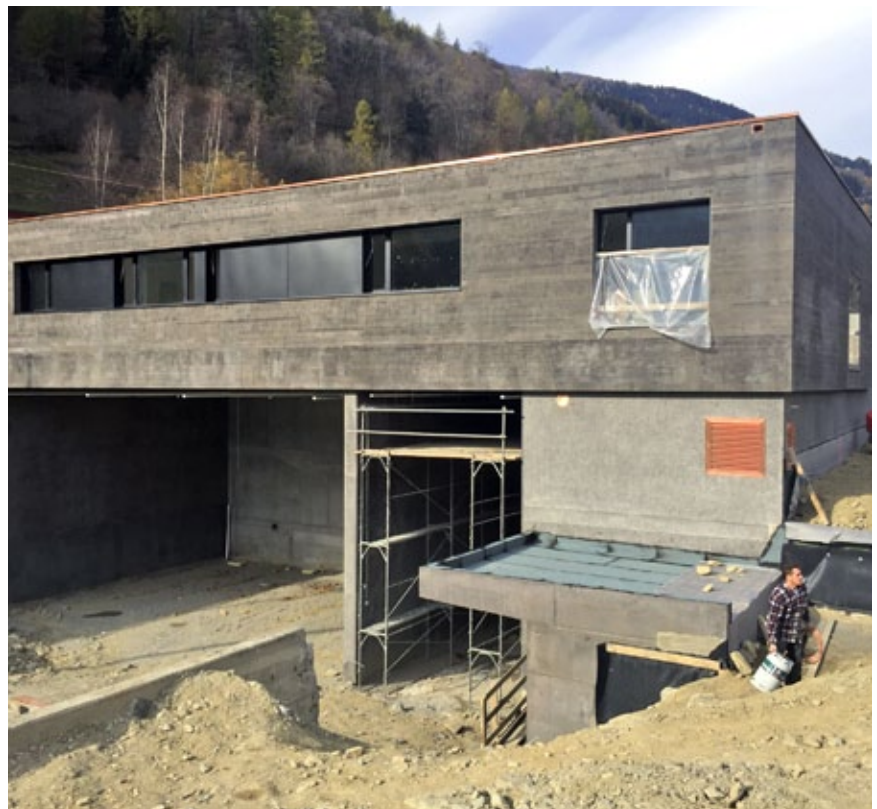
Sicht auf das fast fertige Gebäude, ausgeführt in Sichtbeton. Die Gleise in der Halle werden im 2018 verlegt.
