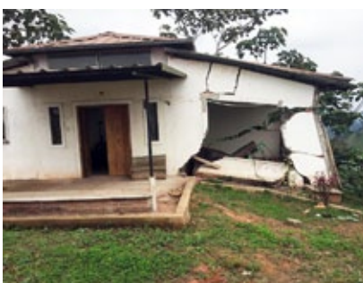
Die Erdbebenschäden sind noch sichtbar.
