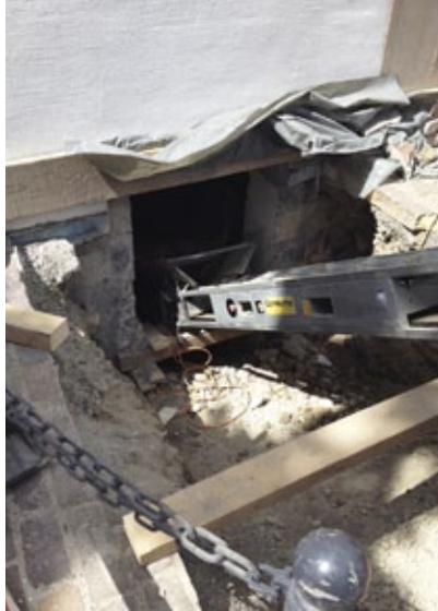
Um das Material ins Freie zu bringen, rissen wir ein Loch in die Fassade.
