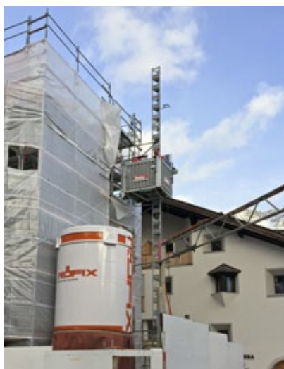
Für den Innenausbau musste alles über das Treppenhaus oder über unseren Fassadenlift transportiert werden.
