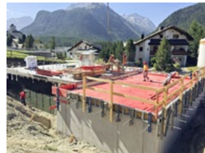
Vorbildliche Absturzsicherung bei der Garagendecke.
