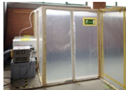
Eine perfekt installierte Schutzzone mit signalisiertem Notausgang.
