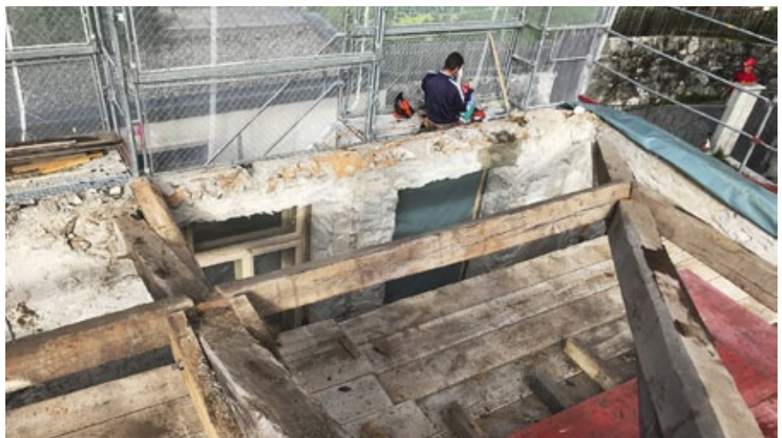
Auf den Seitenwänden wurde später ein Betonkranz erstellt, um ein Auflager für die Pfetten zu erhalten.
