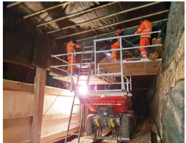
Mit einer eigens konstruierten Plattform auf unserem Schienendumper, befestigten wir vor den Schneidarbeiten einen Schutzplastik unter der Galerie.
