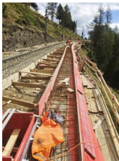
Eine der letzten Betonarbeiten betraf die Verlängerung des Kordons Richtung Alp Grüm.
