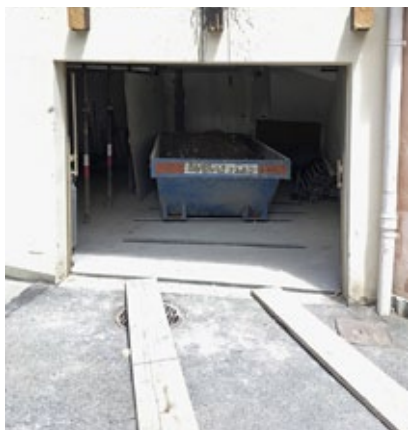
Die Welaki Mulde schoben wir auf Rollen in die Garage.
