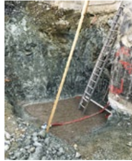
Bei der Liftunterfahrt stiessen wir sogar noch auf Wasser.
