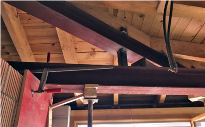
Sämtliche Zwischenwände und Böden in der Dachwohnung wurden entfernt und neue Stahlträger eingezogen und verschweisst.
