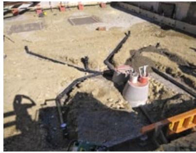
Leitungen und Schächte unter der Bodenplatte.
