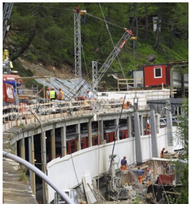
Die ersten Betonstützen werden mit dem von uns selber konstruiertem Kran versetzt.
