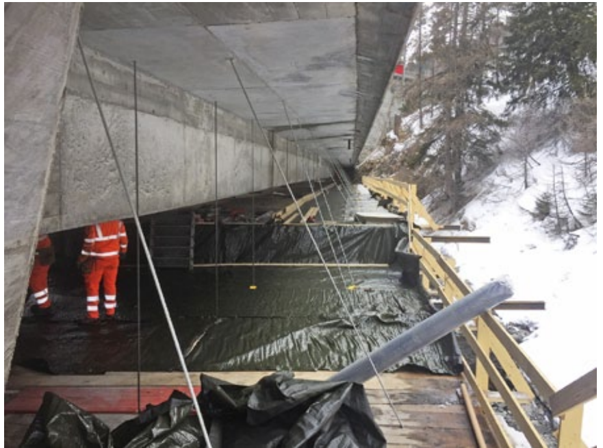
Das Arbeitsgerüst ist bereit um das kontaminierte Wasser beim Abtrennen des Kordons zu fassen.
