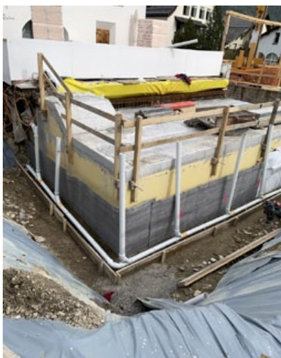
Sickerleitung mit Spülstützen und diversen Anschlüssen.
