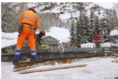
Noch musste das Fachwerk aus Stahl eingebaut und das Dach aufgerichtet werden.
