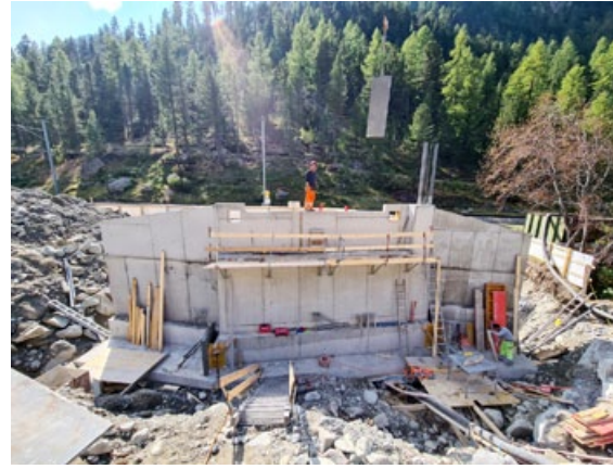
Das linksufrige Widerlager, kurz bevor das Hochwasser kam.
