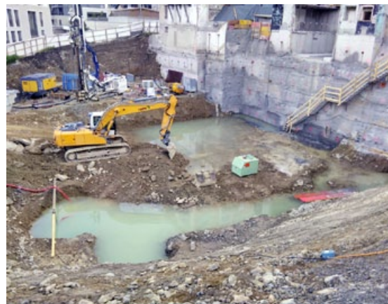
Beim Baugrubenaushub kam Hangwasser zum Vorschein.
