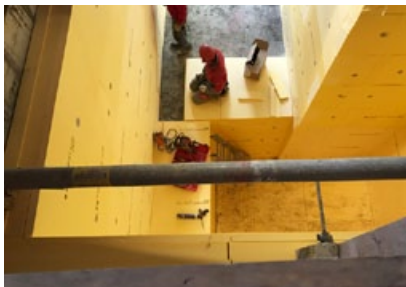
Auf den Negativbeton kamen zwischen 12 - 20 cm Isolation und erst dann kamen die eigentlichen Betonwände.
