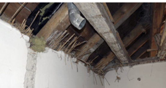
Als Putzgrund und Isolation dienen früher Schilfmatten (obwohl es kein Schilf gibt im Engadin).
