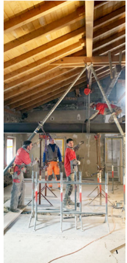
Kein Problem für unsere Mitarbeiter, einen Stahlträger von 410 kg von Hand einzubauen.
