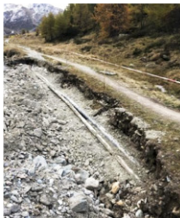
Das weggeschwemmte Ufer mit den freigelegten Glasfaser- und Telefonleitungen, welche wiederum geschützt werden mussten.
