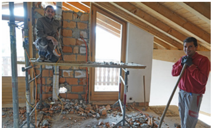
Vorarbeiter Alberto Bracchi und Luca Bormolini spitzen einen Leitungsschacht frei, das Gerüst entspricht nicht unbedingt den Suvavorschriften.
