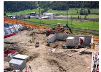
Bevor die Bodenplatte erstellt werden konnte, wurde bereits ein halbes Stockwerk Riegel, Scheiben und Pfeiler gebaut
