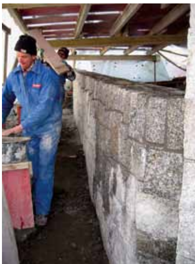
Bis am 18. Dezember 2008 erstellten wir unter einem Notdach mit Heizung die anspruchsvollen Bruchsteinarbeiten. Im Bild Sisto Besseghini
