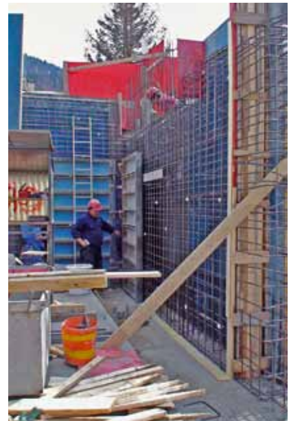
Kaum war der erste Teil der Bodenplatte betoniert, folgte bereits die Wandschalung
