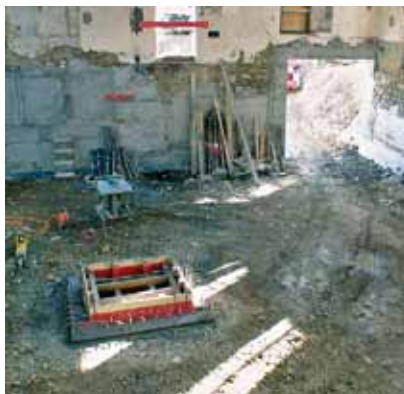
Der Wiederaufbau konnte von unten nach oben beginnen. In der Mitte die Liftvertiefung
