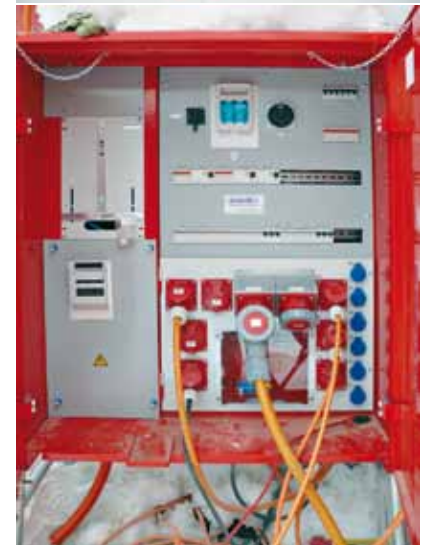
bereits umgerüstete Elektrokabel und Übergangsstücke unsere neuen Verteilkästen mit den Euro Stecker Anschlüssen
