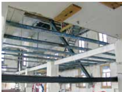
Im 3.OG wurde zuerst eine Decke eingebaut, um das ganze Gebäude zusammenzuhalten
