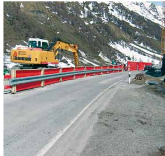
Sogar mit aufgeschweissten Leitplanken
