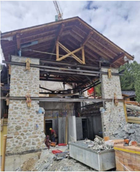
Wiederaufbau im Innern. Die Decken werden auf der gleichen Höhe wie zuvor eingezogen.
