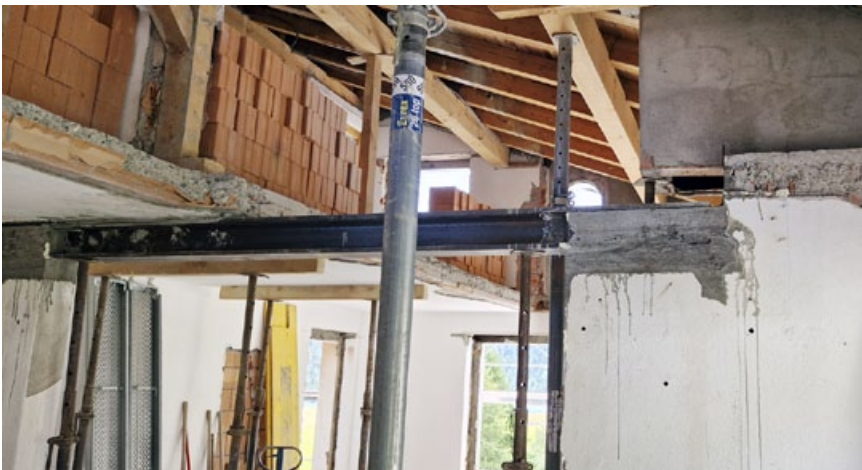
Abfangen der Dachlasten via HEM Träger und überleiten der Last auf die seitlichen Mauerwerke.
