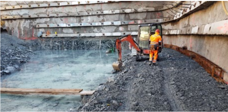
Klar, dass bei so einer Tiefe Hangwasser auftritt.
