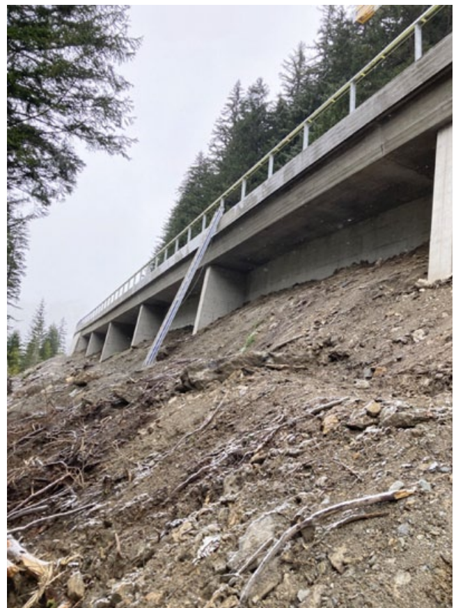
Nach dem Demontieren des Gerüsts, der Baupiste und dem Wiederherstellen des Terrains kann man sich kaum mehr vorstellen, was für Arbeiten voraus gegangen waren.
