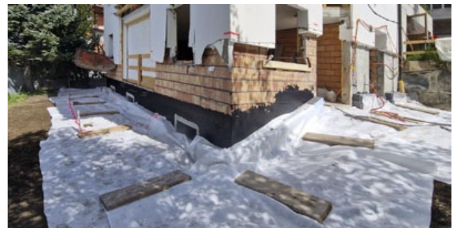
Perfekte Vorbereitung um das Fassadengerüst zu erstellen und die spätere Aufräumarbeit zu erleichtern.
