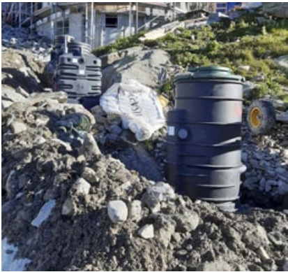
Die Chamanna Coaz verfügt nun über ein modernes Abwassersystem, hier die Kläranlage im Aussenbereich.
