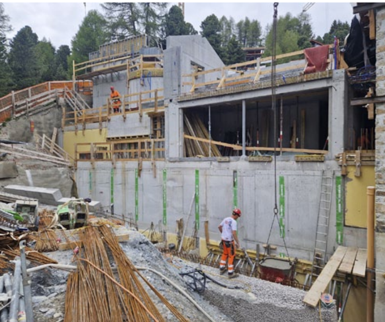
Ersichtlich die schräge Stützmur und die Ebea Einlagen wo die Rippen als nächstes betoniert werden.
